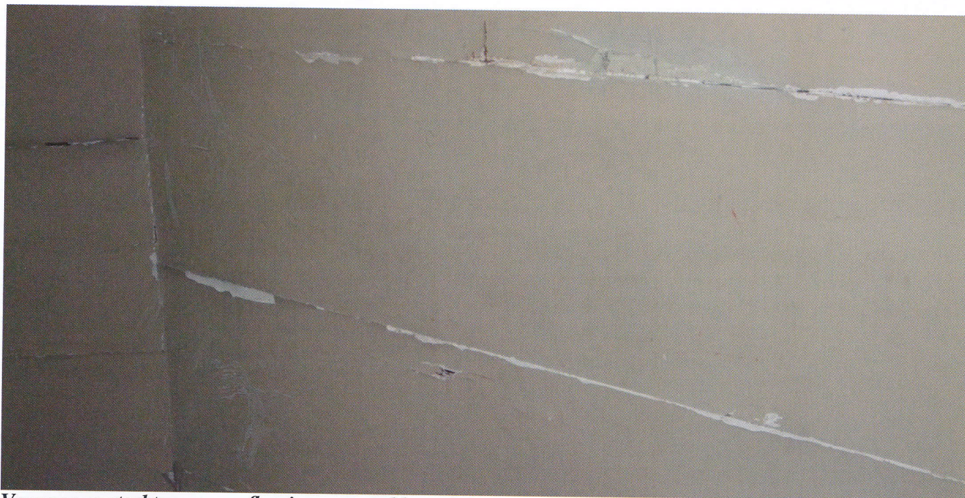
Veggane er sterkt prega av flassing og sprekker.
